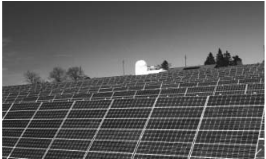
Das Solarkraftwerk auf dem Mont Soleil.
