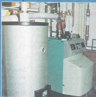
Die gute Heizungsplanung spiegelt sich in einer fachgerechten und sauberen
